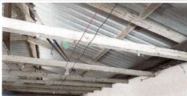
Foto 11: Sustrucción de cableado eléctrico sólido en modulo de cocina
